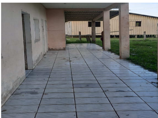
Foto 05: Pátio coberto, piso danificado e antigo.
