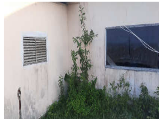
Foto 04: Vista externa da área da cozinha. Esquadrias avariadas.
