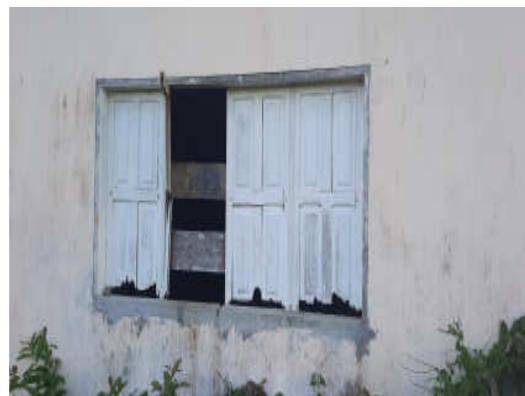
Foto 02: Janelas externas, totalmente deterioradas pela ação do tempo.
