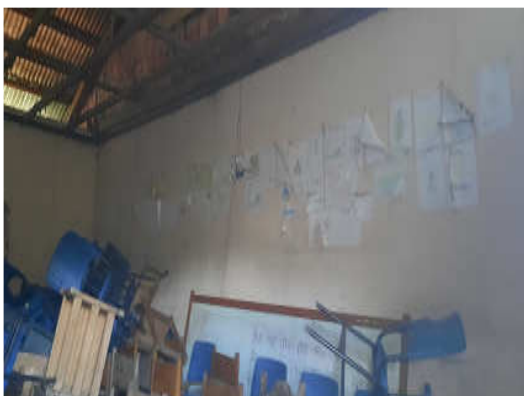
Foto 01: Vista interior da sala de aula, sem forro e com pintura danificada.
