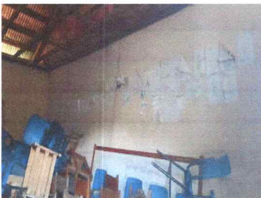
Foto 01: Vista interior da sala de aula, sem forro e com pintura danificada.
