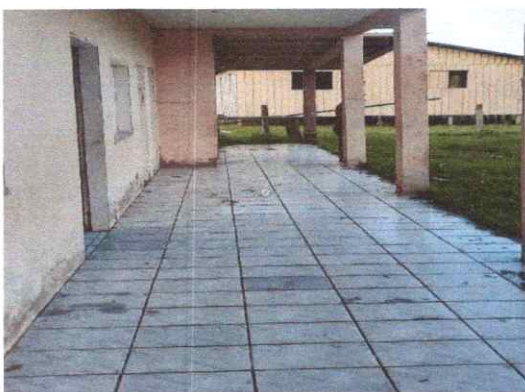
Foto 05: Pátio coberto, piso danificado e antigo.
